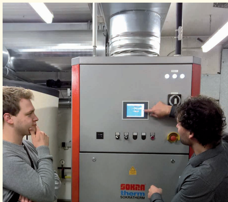
Viele BHKW-Betreiber sind Überzeugungstäter und erklären gern die Technik im Detail.
