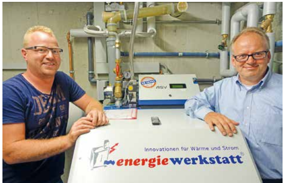
Armin Knie (links) vertrat den Bauherrn bei der Installation und betreut die Anlage; beraten wird er von Hagen Hildebrand, Gebietsverkaufsleiter der Firma Energiewerkstatt.
