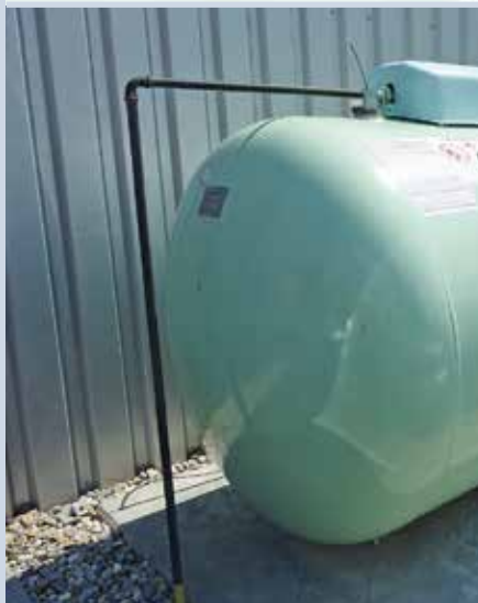
Der Druckgaslagertank, den die tschechische Kadatec fertigte, ist ein Sondermaß und fasst 3,7 t Flüssiggas.
